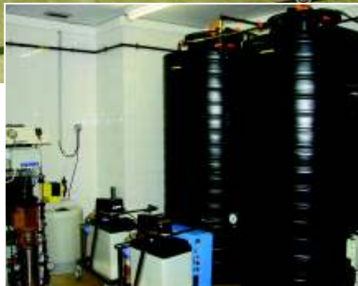
O tratamento da água é fundamental num Serviço de Nefrologia e os HUC não são excepção
